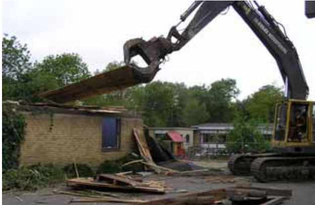
1. Juni 11.45 Uhr: Um- und Ausbau an der Westerstasse 30 in Apenrade zum Dienstleistungszentrum.
